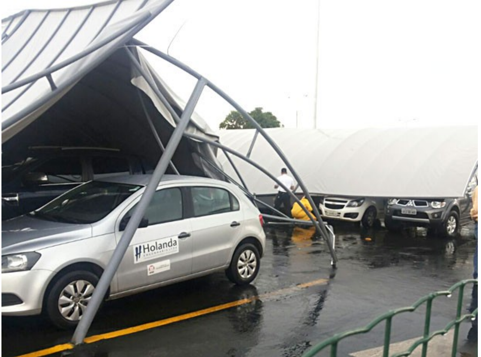
Estrutura de estacionamento caiu sobre carros no Aeroporto JK (Foto: Aldair Fernando/G1)
